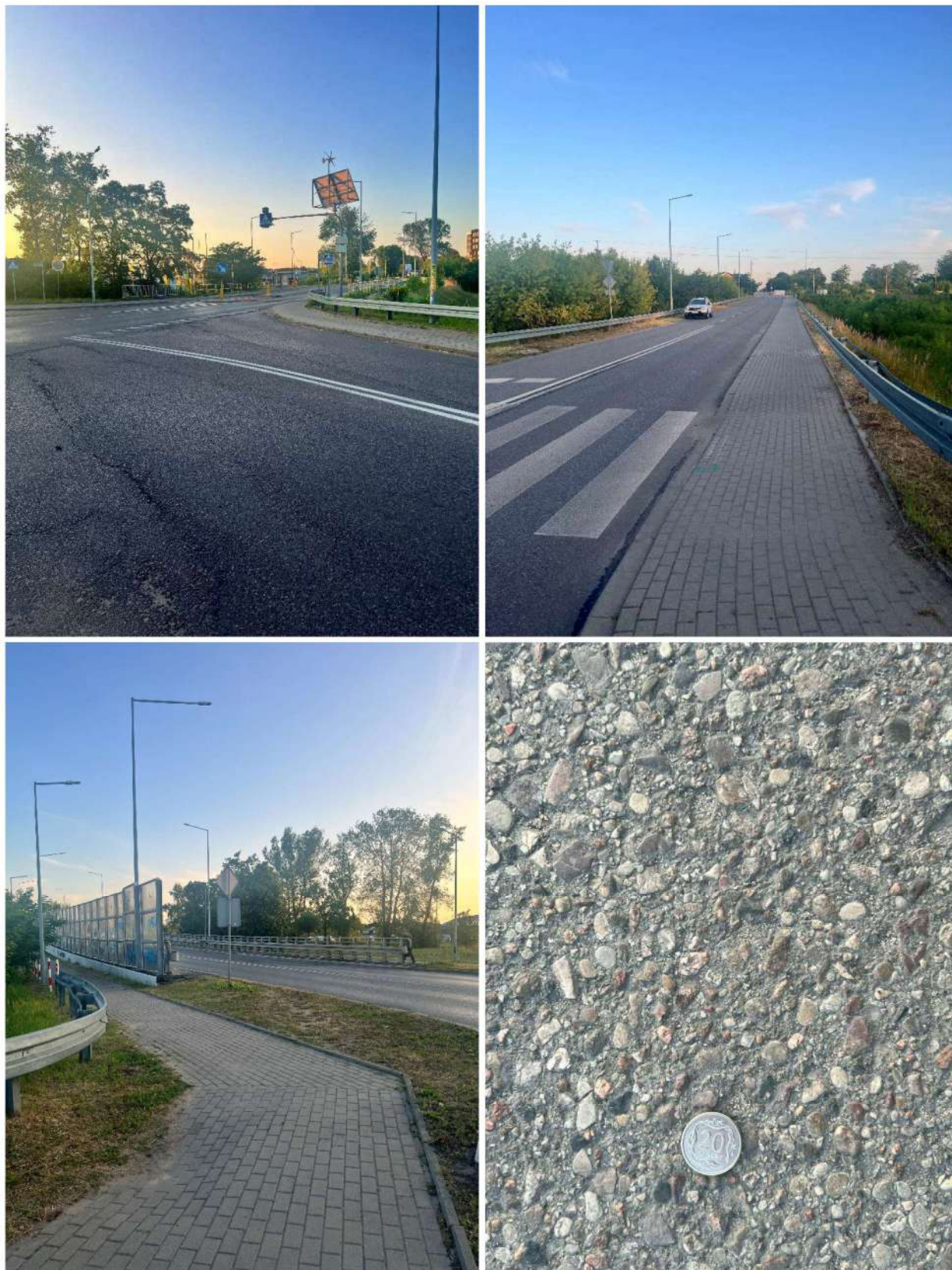
Rys. 5.1 Stan nawierzchni na skrzyżowaniu ulic Generała J.P. Morawicza i Akacjowej
